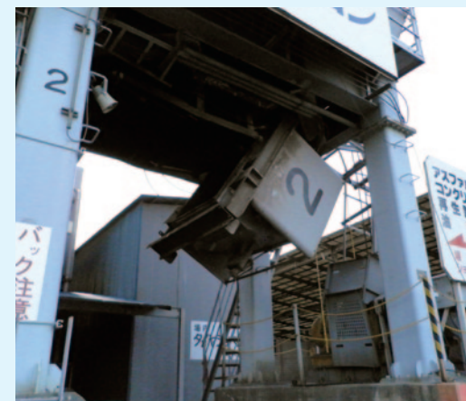
●合材を積み込むミキサ下部ゲートの破損
