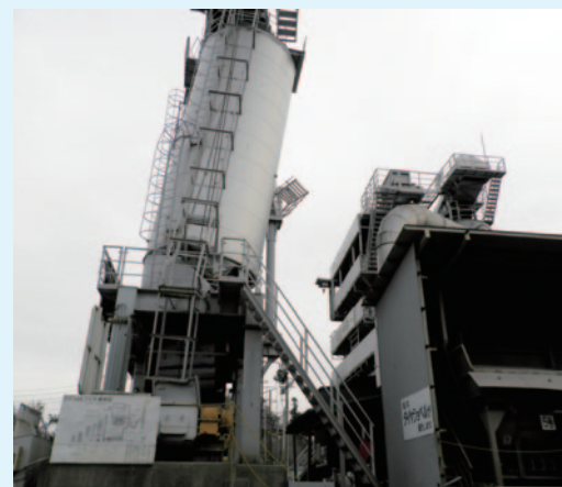
●傾いた合材サイロ。停電により合材が冷えて固まる
