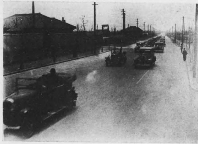
大阪府阿部野堺線シートアスファルト舗装 (昭和六年三月弊社施工)
