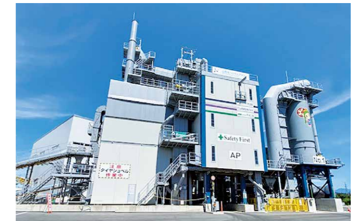
アスファルトプラント(山形工場)
